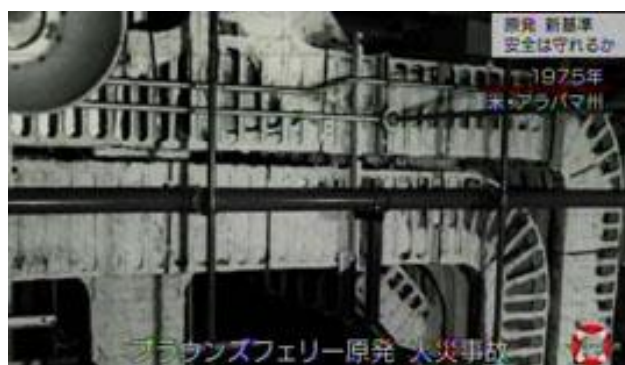
ブラウンスフェリー原発火災事故後のケーブルトレイの状態
